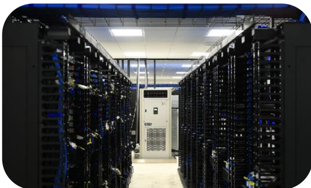
Защищенные серверные помещения с резервированием
