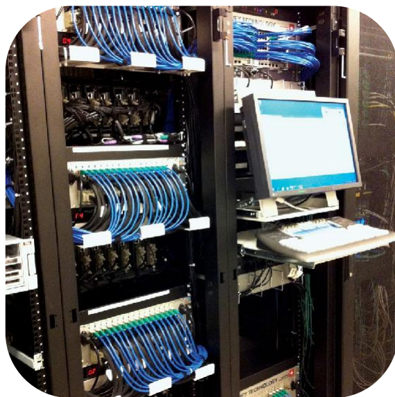
Серверное помещение в Vattenfall
