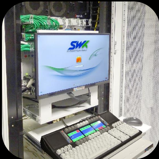
Серверное помещение с панелью управления
