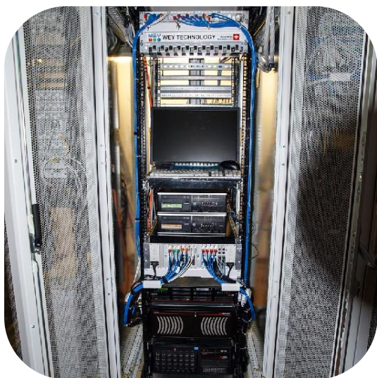
Стойка в серверной
