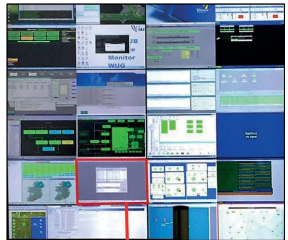
Blinkende Umrandung der Quelle, die den Alarm ausgelöst hat.
